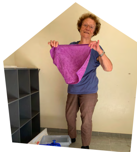
2. Boissy-le-Sec : remise en état de 2 logements (lessivage, peinture, petites réparations électriques, remise en état de volets en bois ...)
